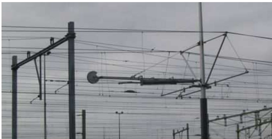
Figuur 32 Bovenleidingafspanning met veren te Amsterdam - foto TransTec
