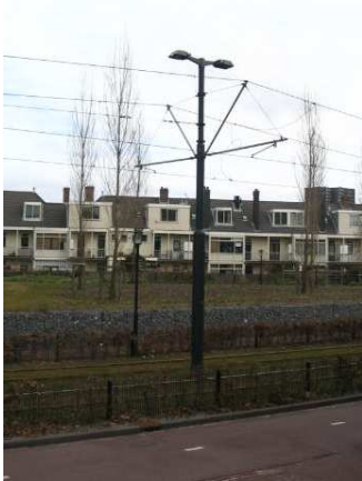
Figuur 30 Middenmast met verlichting – foto TransTec
