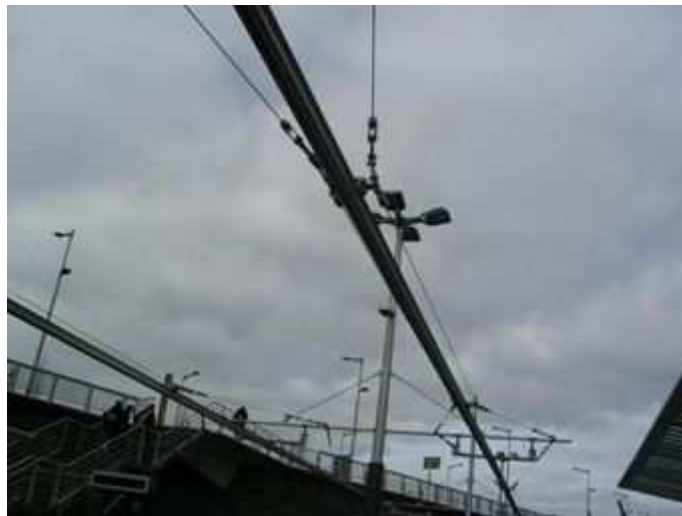
Figuur 21 In flexibel opgehangen stroomrail ingeklemde rijdraad in de Piet Heintunnel Amsterdam – foto TransTec
