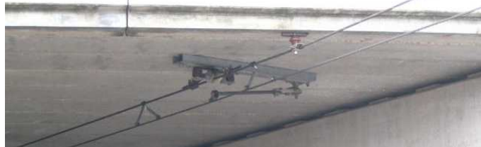
Figuur 20 Constructie van een onder een viaduct doorlopende flexibele draagkabelophanging, rijdraad hangt op 3,9 meter – foto TransTec
