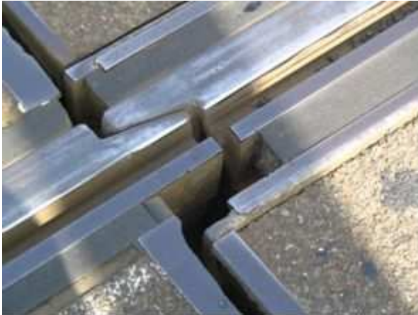
Figuur 6 Brugrail met overgangs-las in basculebrug – foto TransTec
